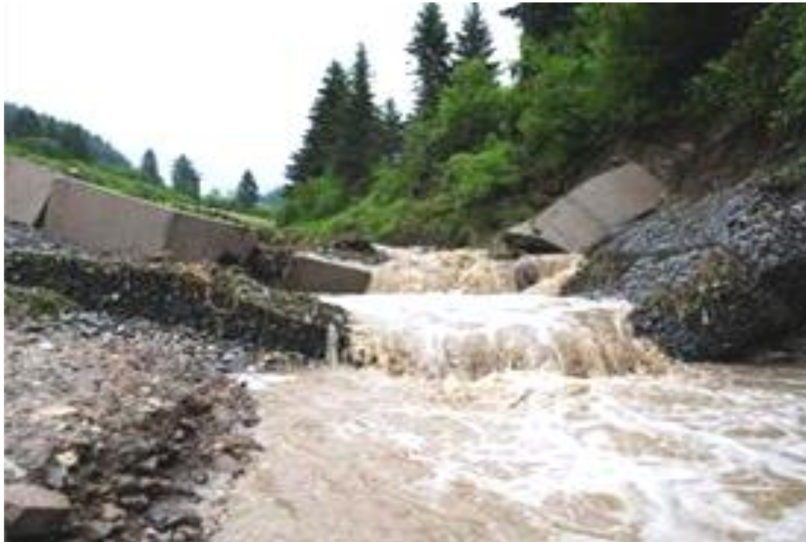
Deštrukcia gabionovej konštrukcie
