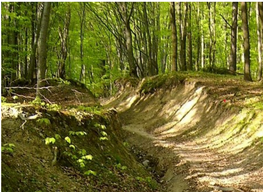
Obrázok 2.3 Zahĺbenie lesnej zemnej cesty pod povrch okolitého terénu v dôsledku výmoľovej erózie
